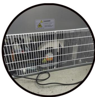
Rejilla protectora en el compresor
